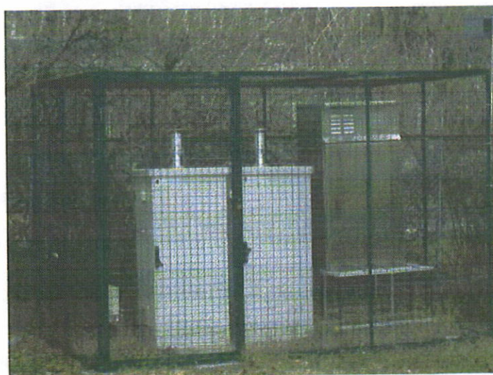
Stacja „SIELSKA” – pomiary emisji zanieczyszczeń powietrza pyłem PM10 i pyłem PM 2,5 metodą manualną
