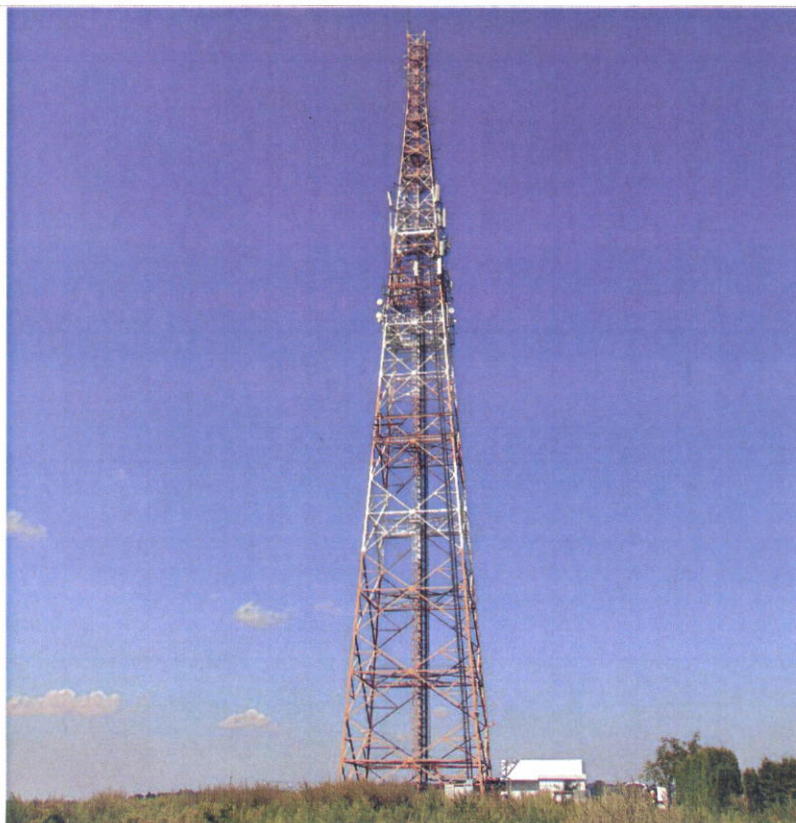
Fot. 1. RON Włocławek / ul. Dobrzyńska – widok wieży antenowej
