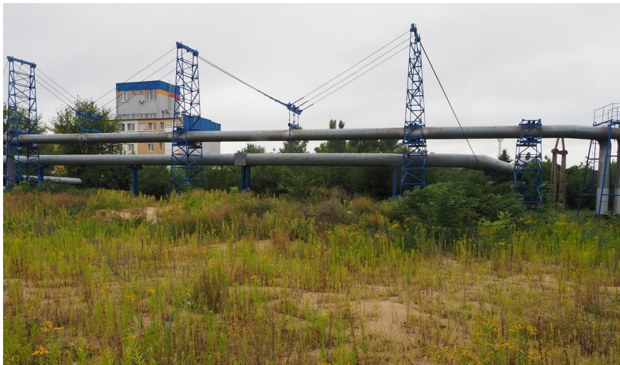
Źródło: Raport z inwentaryzacji przyrodniczej Fot. 6. Krajobraz zdegradowany po zachodniej stronie inwestycji
